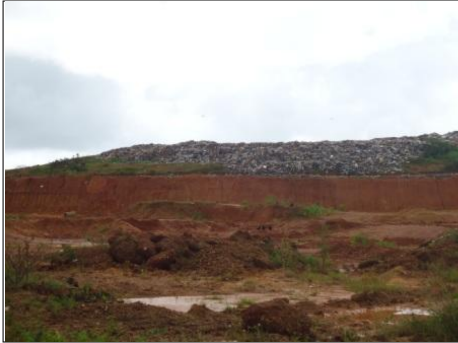
Foto 6: maciço de resíduos sem cobertura
